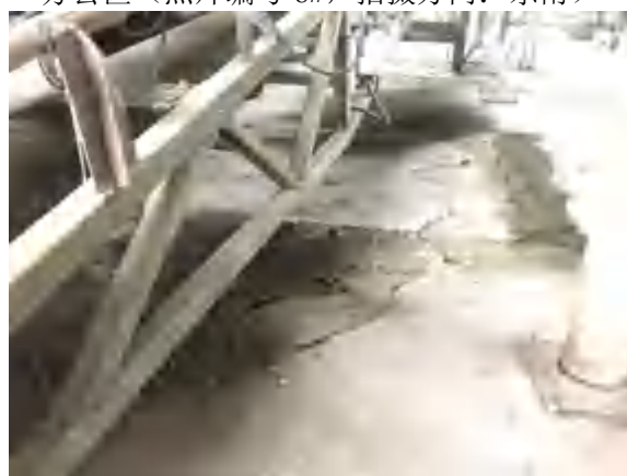
机械堆放区裂缝（照片编号 10#，拍摄方向：东）
