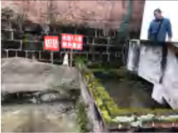
消防池（连接实验室器皿清洗废水排口）
